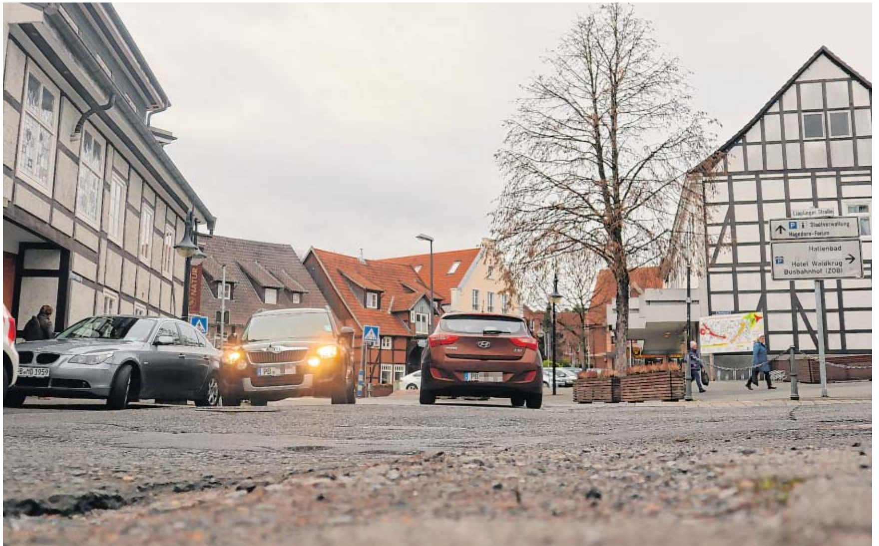
Mitten in Delbrück: Ein Blick auf die Fahrbahn zeigt, wie notwendig die Sanierung ist. Im Hintergrund befindet sich der Alte Markt, rechts die Lipplinger Straße, links ist der Eingang zum Ladenlokal Benslips.
