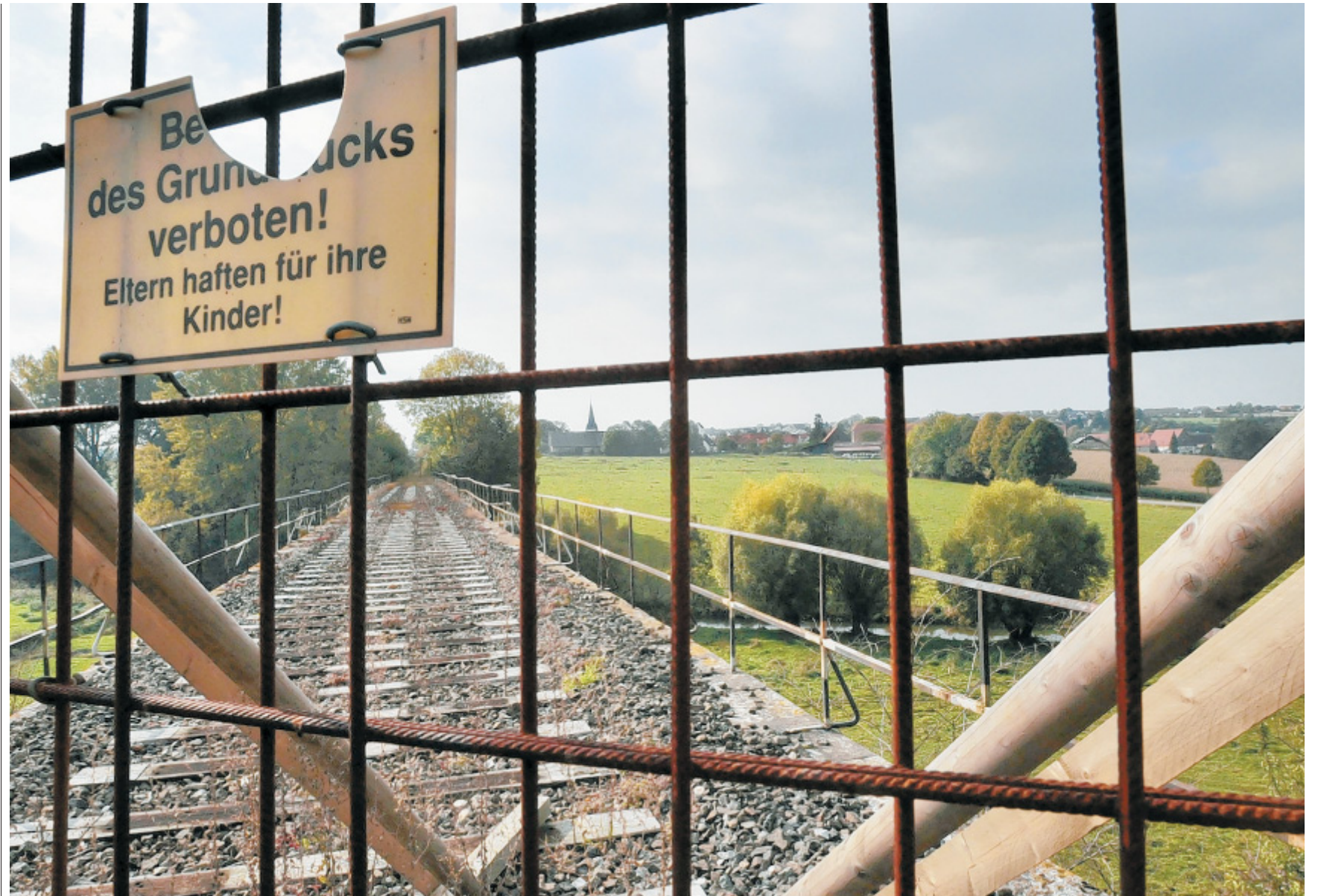
Abgeräumte und abgesperrte Trasse: Der Eigentümer, die Westfälische Almetalbahn GmbH, hat die eisernen Schienen vor Jahren gut verkaufen können. Die mit Holzschutzmitteln getränkten Bohlen sind – wie hier auf der Brücke bei Niederntudorf – liegen geblieben. Das Bauwerk ist gegen unbefugten Zutritt gesichert worden. FOTO: REINHARD ROHLF
